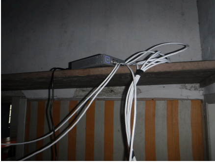
(a) Switch du premier étage
