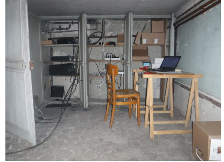
(c) Vue d'ensemble du local technique principal, en entresol à l'Est du Grand Château
