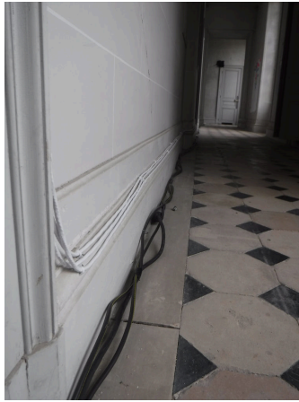
(b) Câblage intérieur (câbles électriques noirs au sol le temps du festival)
