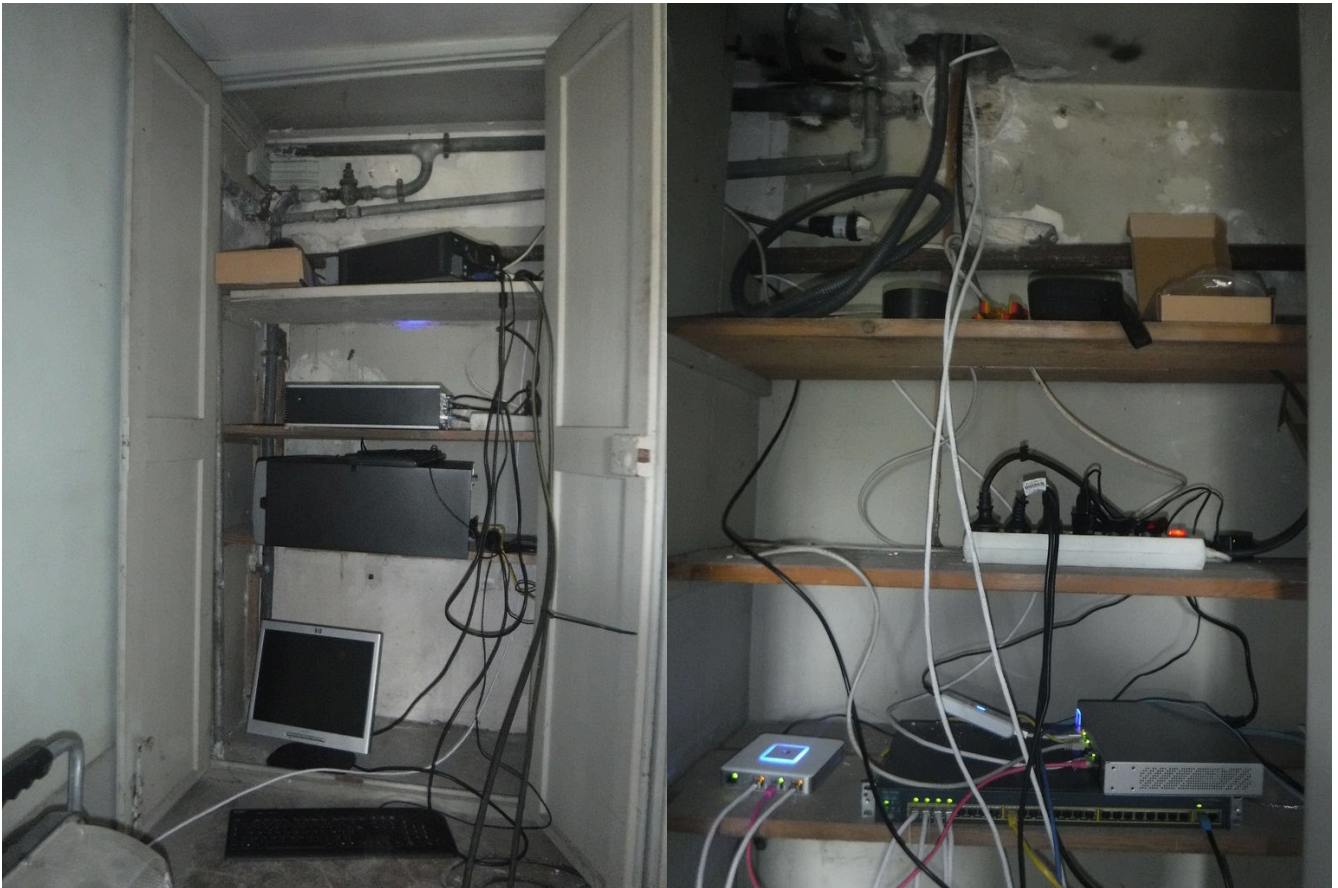
(d) Local technique principal : armoire des serveurs
